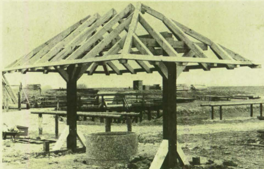
Das Werk ist vollendet! Die Walmdachkonstruktion für einen Schachtbrunnen forderte von den Helfern all ihr Können.
