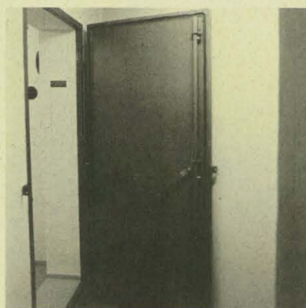
Die Zarge der gasdichten und feuerhemmenden Schleusentür wird sofort mit einbetoniert, dadurch ist die Gasdichtigkeit des gesamten Schutzraums gewährleistet.
