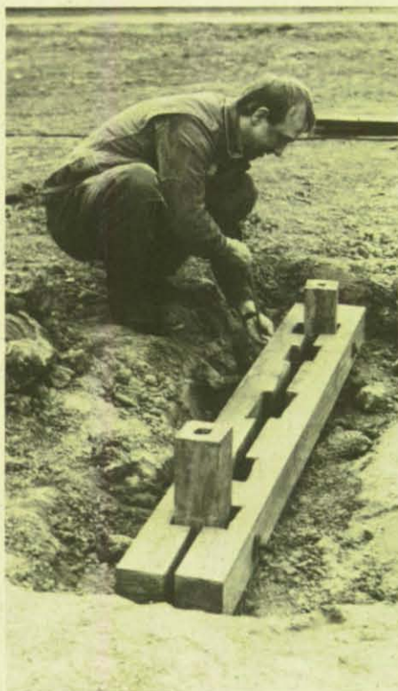
Die Zangenverbindung aus hartem afrikanischem Bongossiholz wird im Erdbereich mit Bolzen gesichert.
