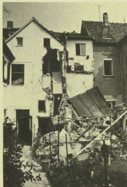
Die Schadenslage an der Rückseite des Hauses.
