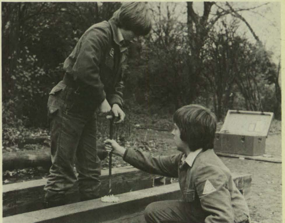
Nachdem die Abstände aufgezeichnet wurden, kann jetzt mit dem Bohren angefangen werden. In diese Löcher kommen Ösen für die Kletterseile hinein. Doch bis dahin ist's noch lang...
