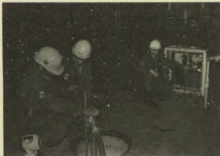
Die Notbrunnen werden von den THW-Helfern nach einer Checkliste gewartet. (Foto: Carstens)
