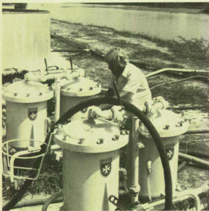
Der MHD setzte hochentwickelte Reinigungsanlagen ein.
