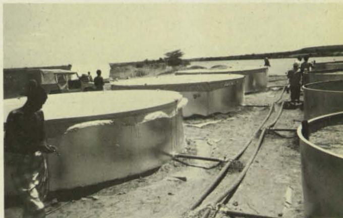
18 Wasseraufbereitungsanlagen versorgen sämtliche Flüchtlingslager im Süden des Landes.
