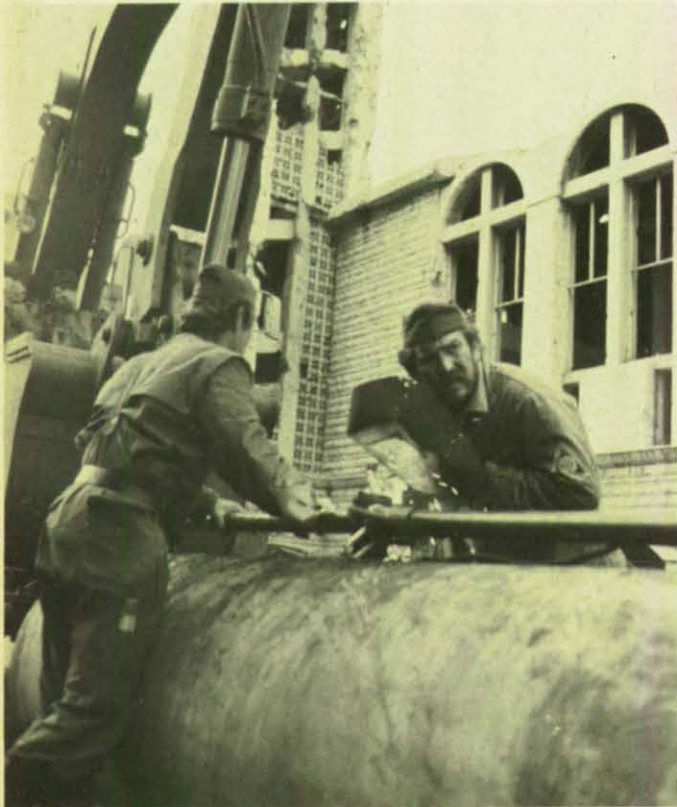
THW-Helfer aus Rosenheim schweißen eine Verstrebung zum Abziehen einer 700-mm-Rohrkupplung; im Hintergrund die zerstörte Kirche St. Michel.
