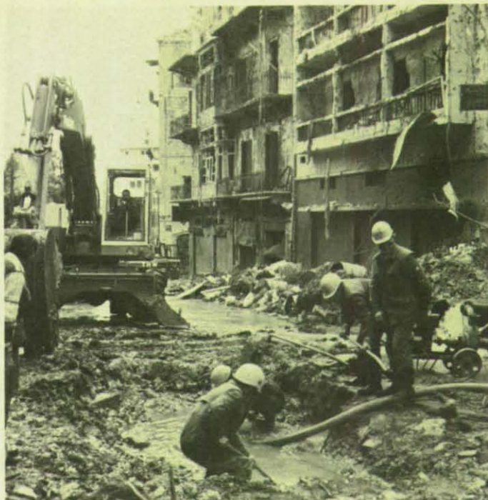
Orten einer Leckstelle in der Rue de Damas.
