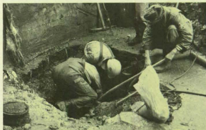
Wieder ist ein Leck im Leitungsnetz gefunden.
