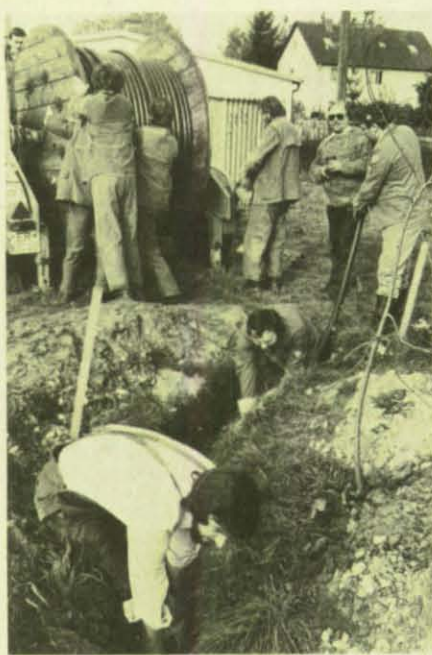
Das von den Stadtwerken für Übungszwecke zur Verfügung gestellte Erdkabel wird in den Kabelgraben verlegt. (Foto: Schreiter)
