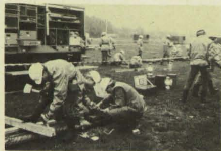
Vorbereitende Holzarbeiten (Stützbockbau) für das Abstützen einer zwei Meter hohen Wand. (Foto: Bormann)
