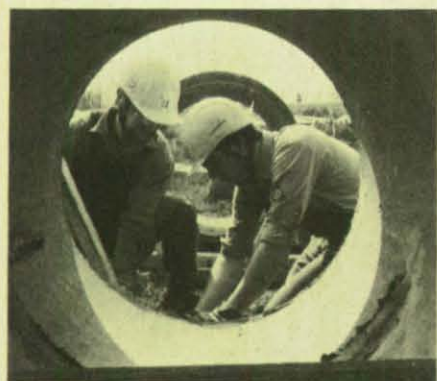
Unten: Ein Mischwasserkanal wird behelfsmäßig instandgesetzt. (Fotos: Wrede)
