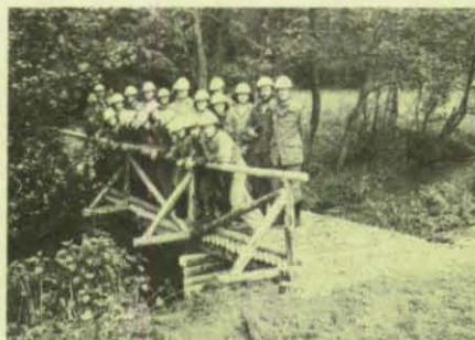
Die erste Belastungsprobe der Brücke: die Jugendgruppen des THW-OV Ellwangen. (Foto: Stelly)
