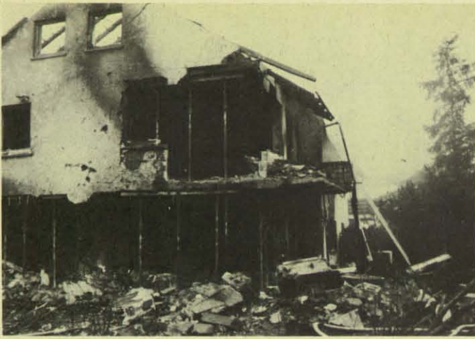
Nicht mehr bewohnbar ist dieses völlig zerstörte Haus.
