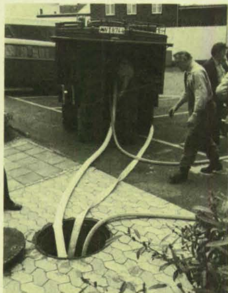
Bild 6d: Trinkwasser-Notversorgung mit Berliner Kombi-Brunnen: Tanklöschfahrzeug (TLF) mit betriebsfertig montierten B-Druckschläuchen für Treib- und Trinkwasser.
