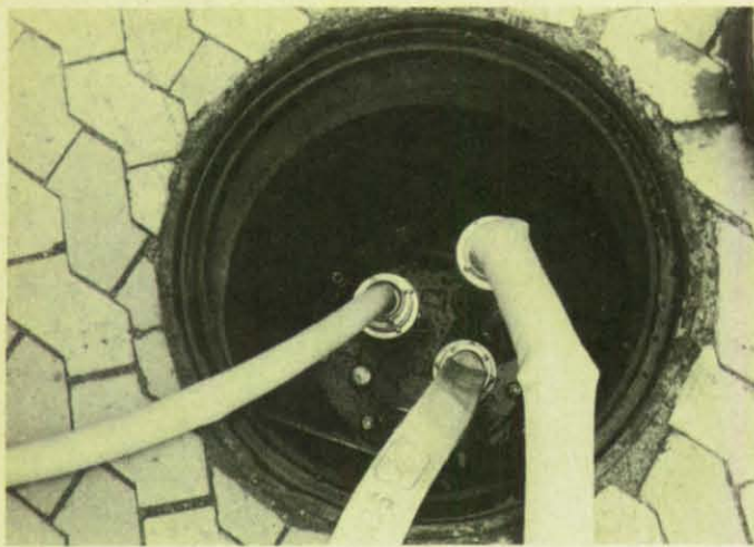
Bild 6b: Berliner Kombi-Brunnen: Blick in den geöffneten Brunnenschacht mit den am Brunnenkopf angekuppelten B-Druckschläuchen für Treibwasserkreislauf und Trinkwasserförderung.
