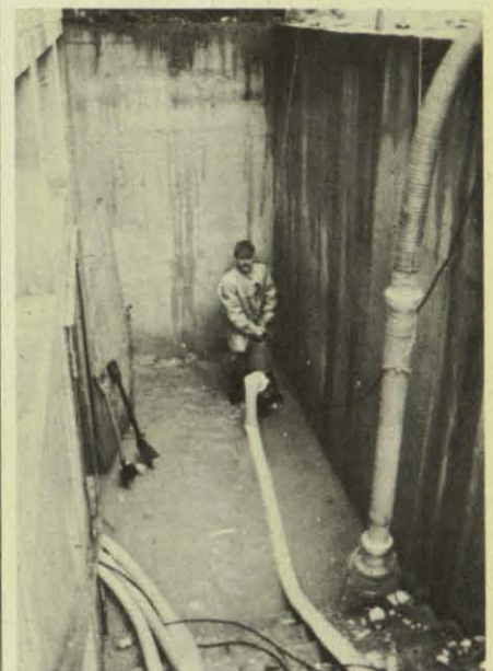
Der Keller einer Schule wird leergepumpt.
