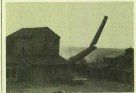
Die Sprengung ist ausgelöst: Der Kamin fällt genau in die vorausberechnete Richtung. (Foto: Kroll)
