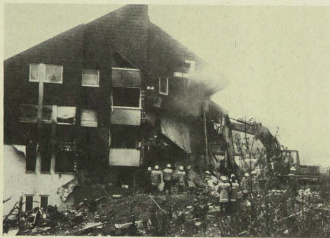
Eingeknickte Hauswände, zerbrochene Fensterscheiben und abgerissene Verkleidungen – das Haus wurde nahezu völlig zerstört.
