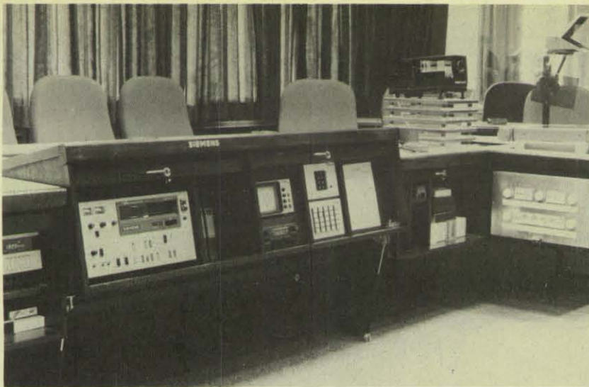
Das Darstellungs- und Nachrichtengerät wurde in den wesentlichsten Elementen in einen speziell angefertigten Arbeitstisch eingebaut.
