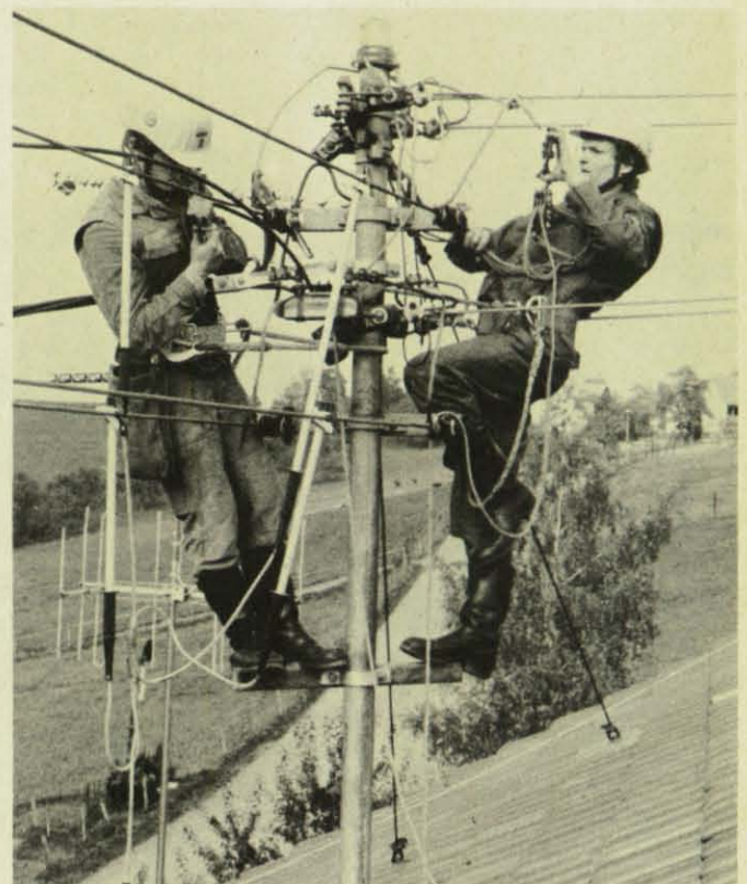
Gut vorbereitet sind die THW-Helfer der Elektro-Gruppe auf den Freileitungsbau. (Foto: Stelly)
