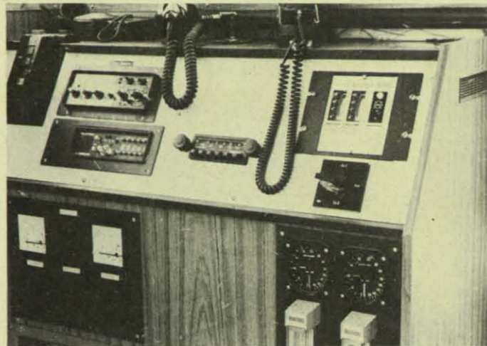
Blick auf die Funk- und Radioanlage, rechts das Exytron-Gerät, mit dem explosive Gemische in der Umgebungsluft festgestellt werden können.
