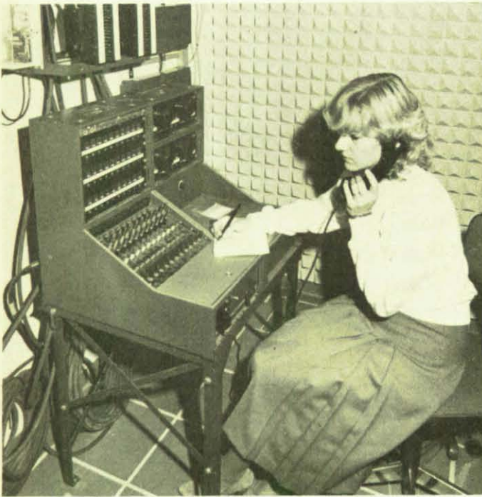
Die Fernsprechvermittlung der Fernmeldezentrale. Die Wände sind mit einem schalldämmenden Belag versehen, um den Geräuschpegel möglichst niedrig zu halten.
