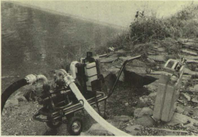
Bild 4: An einem Fluß aufgestellte Rohwasserförderpumpe für den Betrieb der mobilen Trinkwasser-Aufbereitungsanlage.
