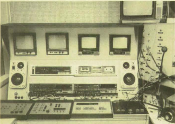
Der Regieraum: Von hier aus wird die gesamte Technik gesteuert.
