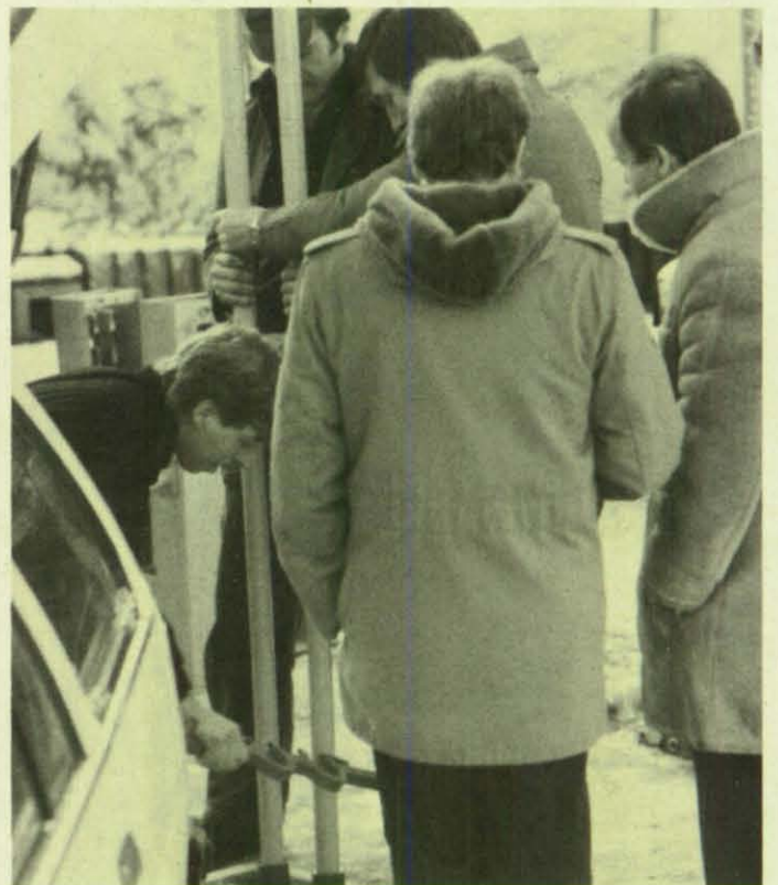
Bild 12: Ablassen der Pumpenstielrohrleitungen und Pumpengestänge mit einer Abfangdoppelschelle in das Brunnenrohr beim Trinkwasser-Notbrunnen Dernau.
