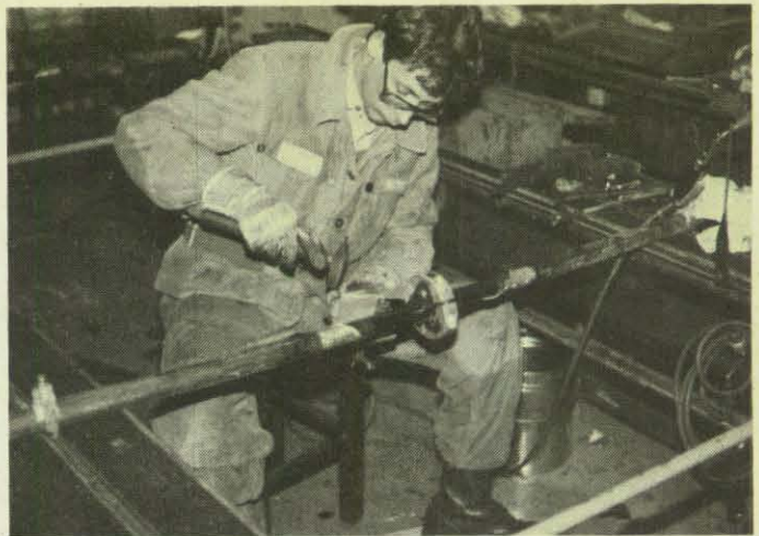
Ein THW-Helfer stellt eine Abzweigverbindung mit einer Kompaktklemme auf einem 10 Kilovolt-Kabel her.
