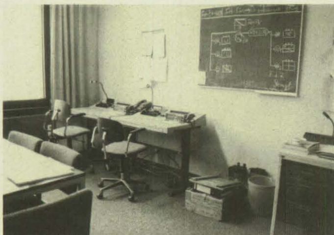
Für die Fernmeldezentrale HVB stehen im Kats-Zentrum fest installierte Funk- und Fernsprecheinrichtungen bereit.
