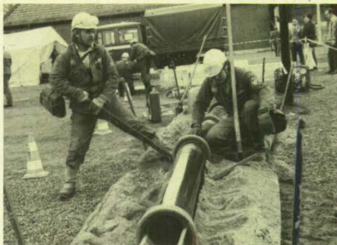
Eine der Wettkampfaufgaben für die Abwasser-Öl-Gruppen war das Verlegen einer Abwasserleitung aus Steinzeugrohr.
