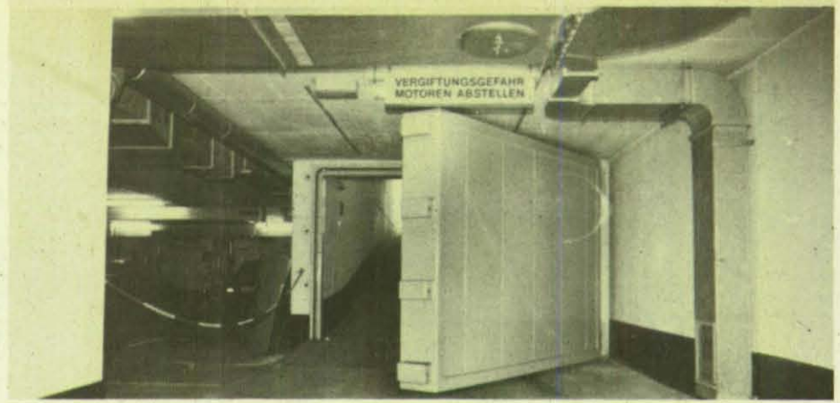
Tiefgaragen, die als Schutzräume ausgebaut worden sind, werden mit großen Stahlbeton-Abschluß-toren im Belegungsfall verschlossen. Bei Normalnutzung bleibt das Tor immer geöffnet.
