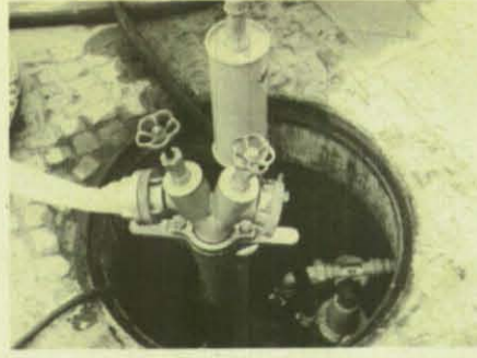
Bild 6: Geöffneter Schacht eines Notbrunnens in Bayern mit kombinierter Lufthebefördereinrichtung: Standrohr mit Absperrventilen und Wasserförderschlauch, Luftzuführungsschlauch, Luftabscheider mit Schalldämpfer, Druckregler, Ölabscheider und Stromkabel (Foto: Günter Sers)
