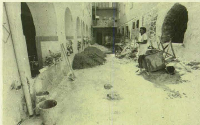
Auf der Baustelle entsteht die 195 Quadratmeter große Ambulanz, die fünf Behandlungsräume und eine Apotheke haben wird.
