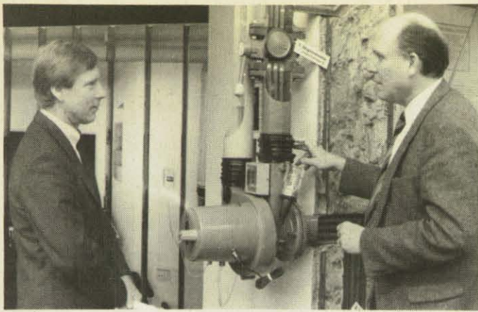
Das Lüftungsgerät gibt immer wieder Anlaß zu detaillierten Fragen.
