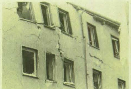
An der Frontseite des Mehrfamilienhauses wölbt sich die Fassade zum Teil nach außen, alle Fenster sind zerstört.
