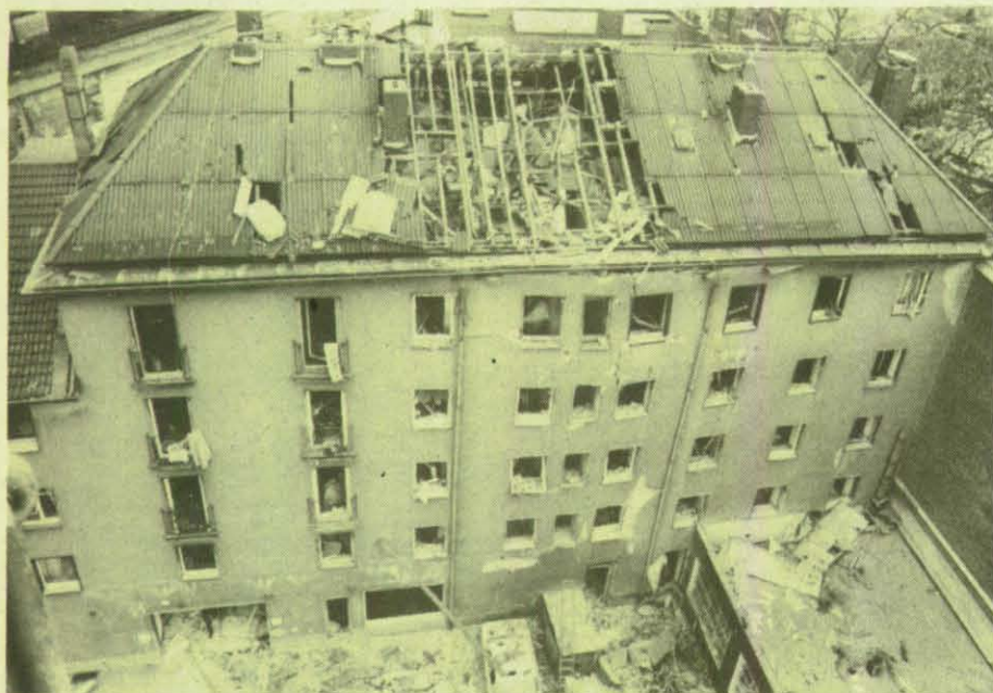
Es sieht aus, als hätte eine Bombe eingeschlagen. Nach der Explosion droht das Haus einzustürzen.
