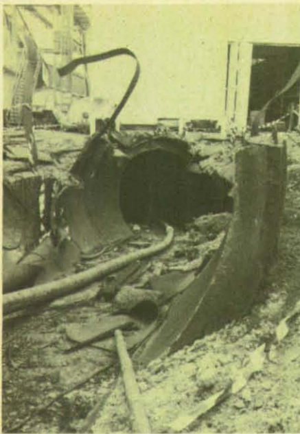
Die Einfahrt des Schrägstollens wurde durch die Explosion völlig zerstört.
