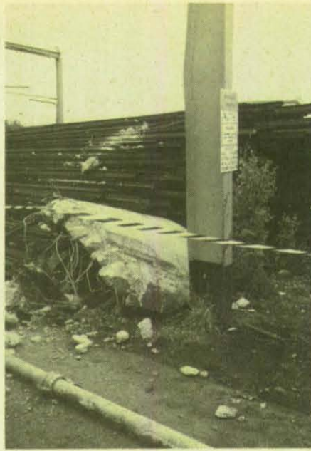
Über 200 Meter weit geschleudert wurden die schweren Betonteile des Schrägstollens.
