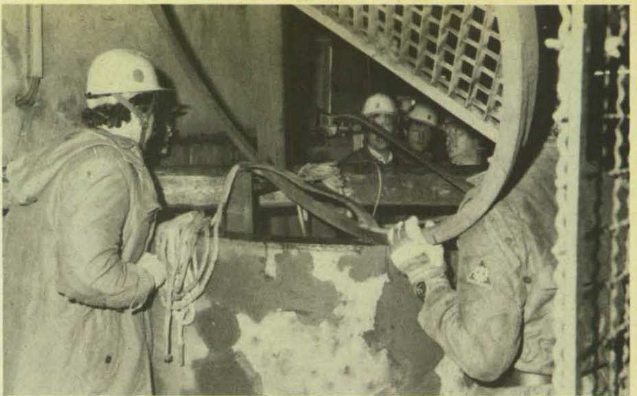
THW-Helfer bereiten den schwerbeschädigten Schachtkopf zum Einstieg der Grubenwehren vor.
