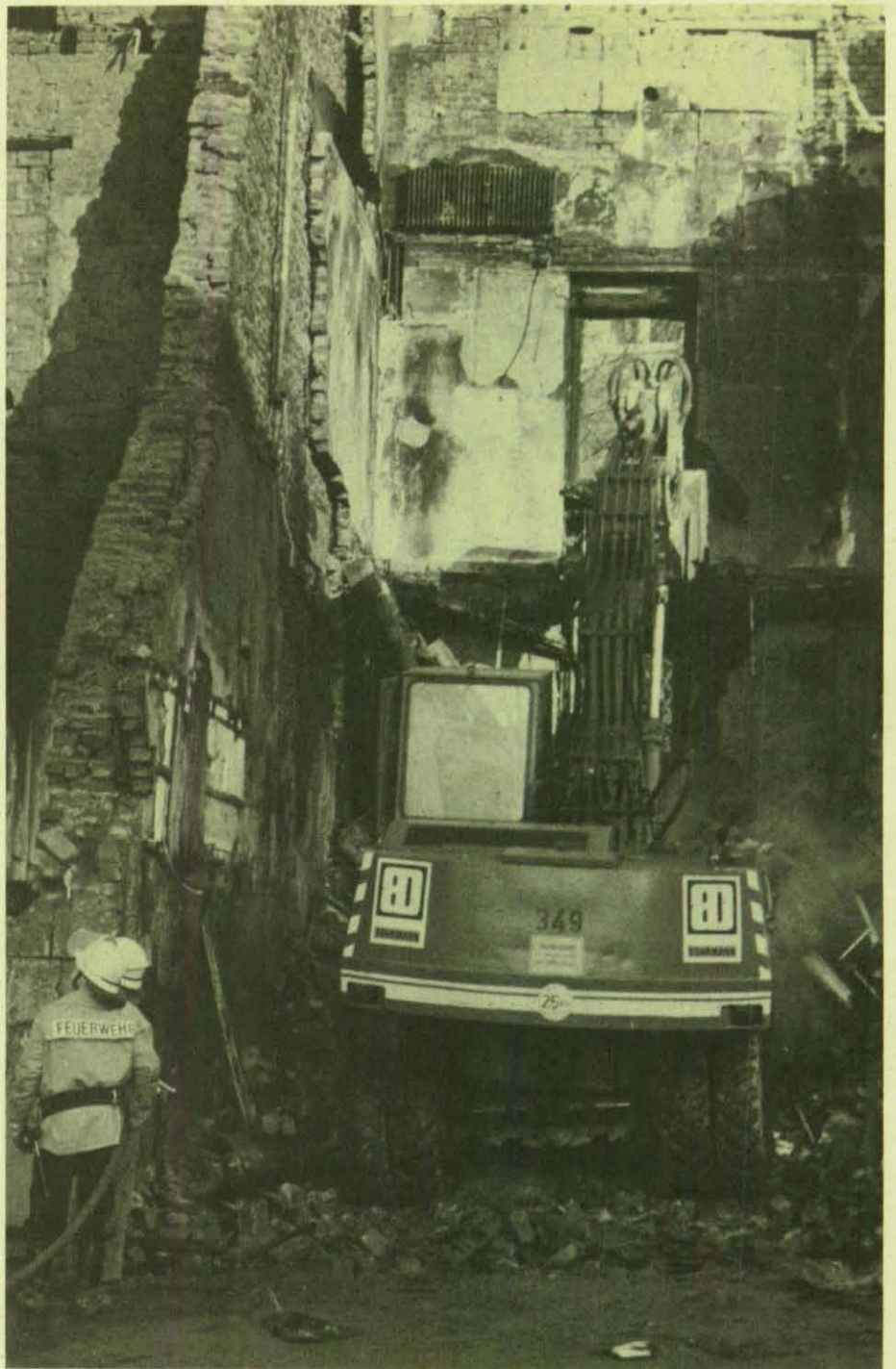
Zwei Häuser müssen total abgebrochen werden.
