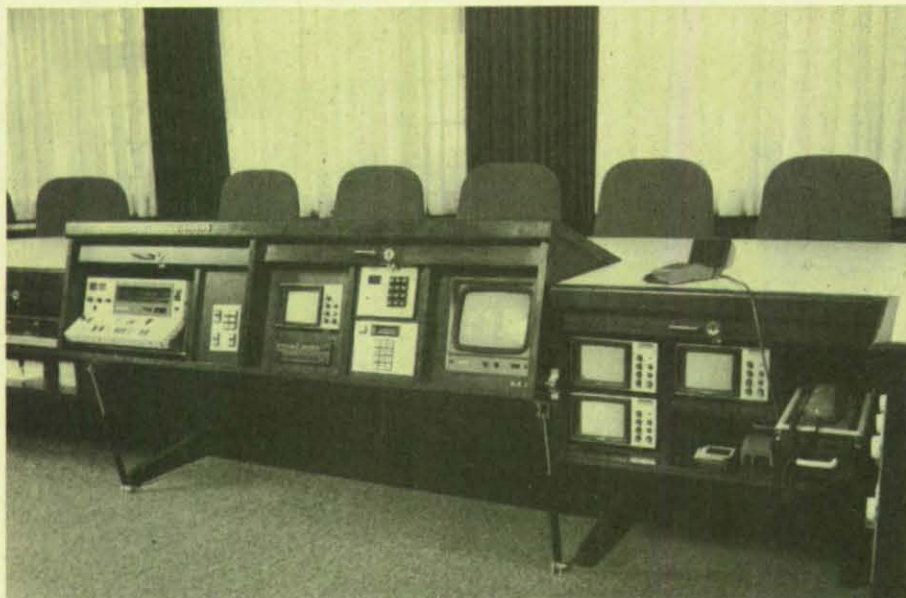
Die Darstellungs- und Nachrichtengeräte sind in den wesentlichen Elementen in einem speziell angefertigten Arbeitstisch eingebaut.
