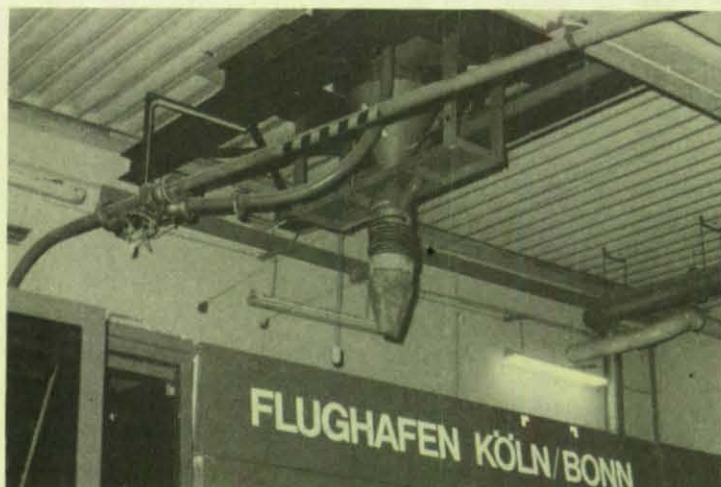
Nach einem Einsatz lassen sich die Fahrzeuge mit der unter der Hallendecke angebrachten Pulverfüllanlage schnell wieder einsatzbereit machen. (Fotos: Claes)
