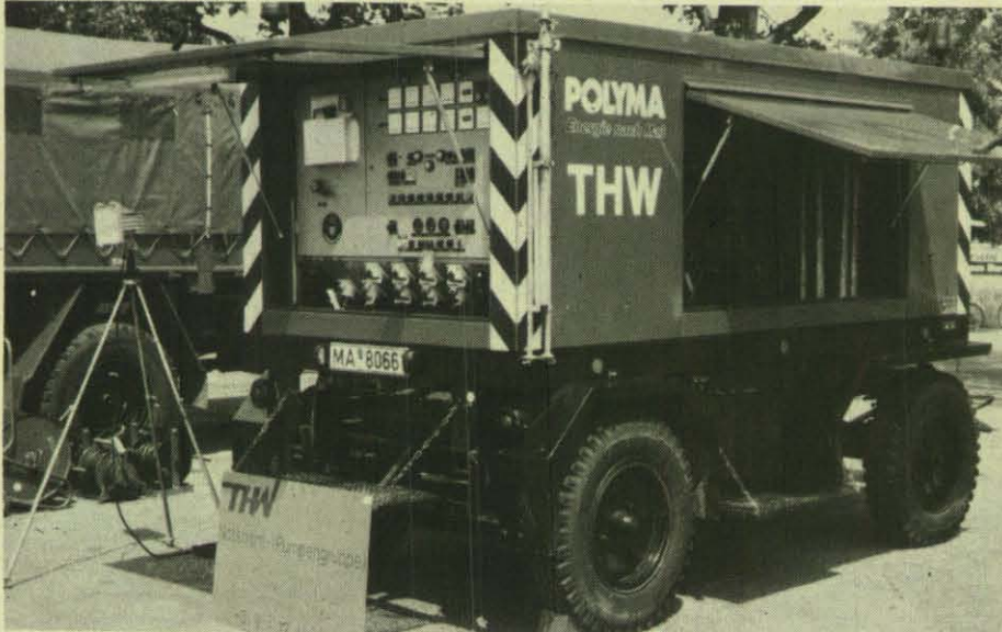
Der THW-OV Mannheim stellt u. a. eine Notstrom-Pumpengruppe mit einem Stromerzeuger 175 kVA aus.
