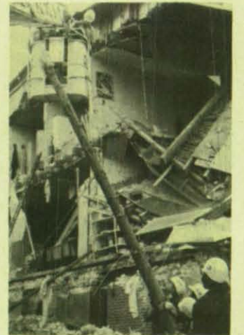
Rundhölzer sollen das angeschlagene Haus vor dem völligen Einsturz bewahren.
