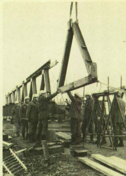
Ein schwerer Kran ist bei der Montage hilfreich. Er schwenkt die einzelnen Felder ein.
