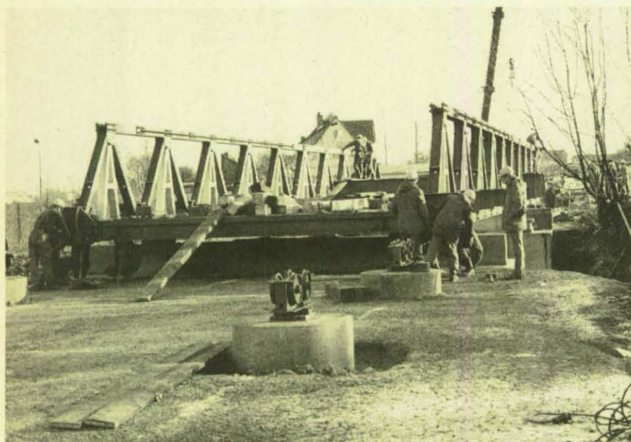
Die Brücke steht auf den Widerlagern. Im Vordergrund sind die Rollenlager zu sehen.
