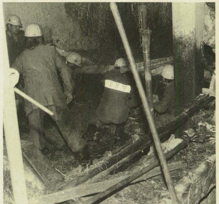
Nach der Absicherung der restlichen Stalldecke werden die heruntergestürzten Betonteile mit Hebekissen und Öldruckheber angehoben, um die Tiere zu bergen.
