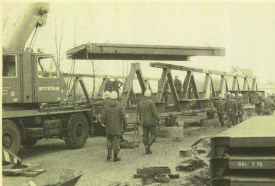
Über drei Tonnen schwer sind die einzelnen Flachfahrbahnplatten, die hier eingebaut werden.
