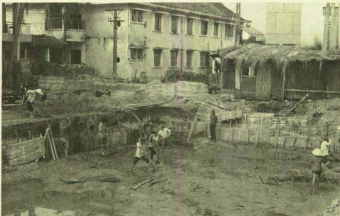
Eine einzige Baustelle: Der Krankenhausbereich steht unter Wasser.
