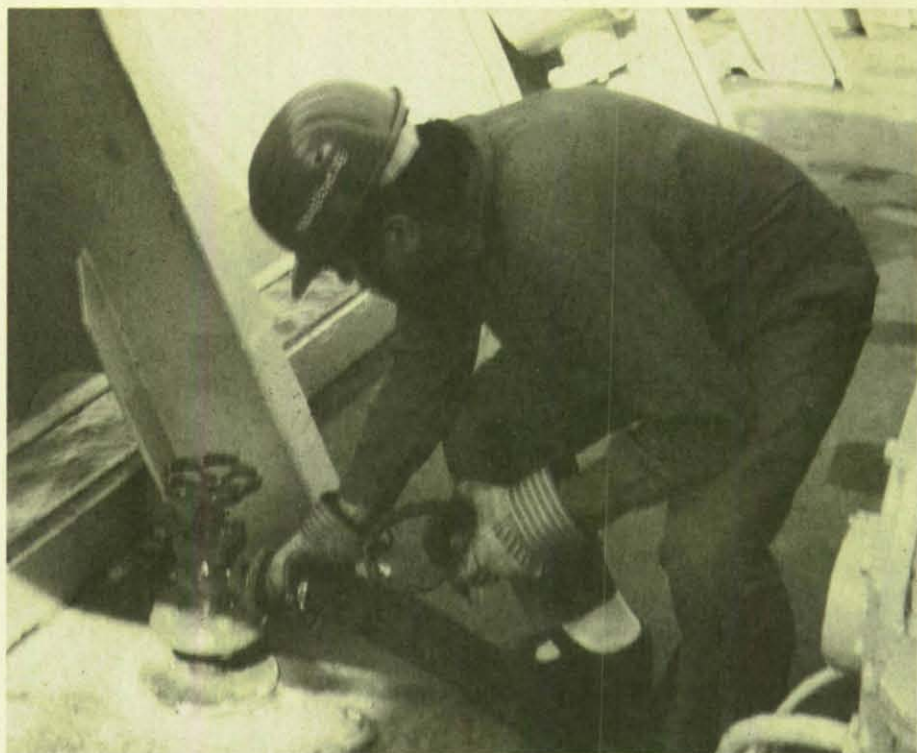
Eine wichtige „Banalität“ ist das wöchentliche Überprüfen und Spülen der Löschwasseranschlüsse.
