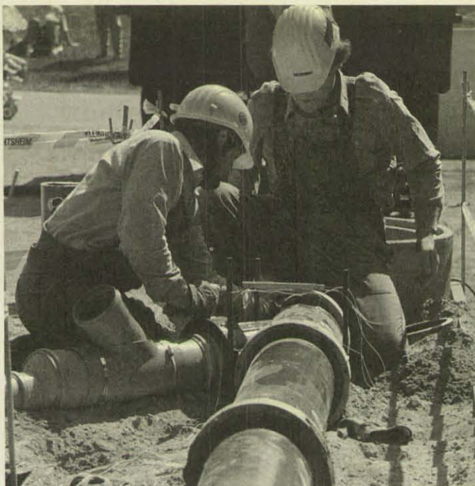
Die Abwasser-/Öl-Gruppe muß einen fachgerechten Abzweig an einer Abwasserleitung herstellen.
