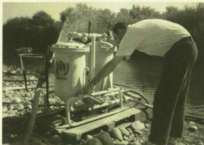
Das Kernstück der Filteranlage.
