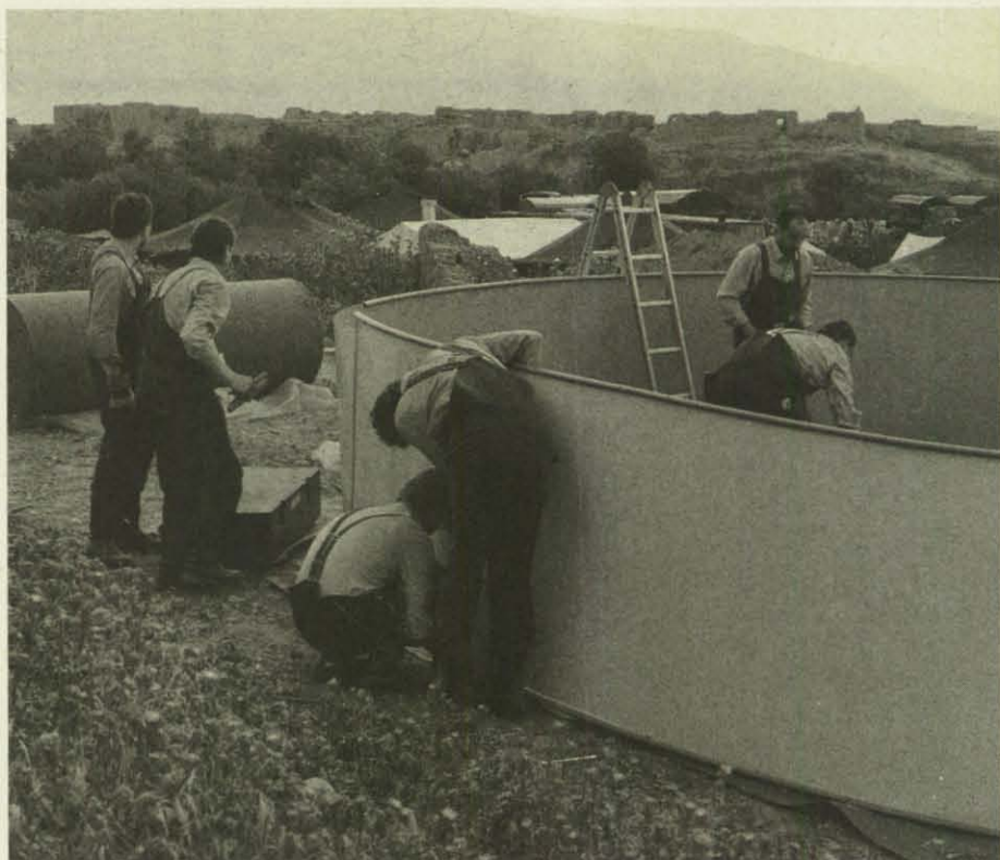
Die Einrichtung von Trinkwassertanks im eigenen Camp ermöglicht eine gewisse Bevorratung.
