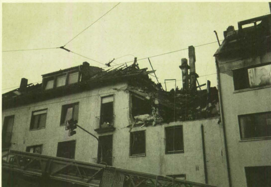
Das Foto verdeutlicht die umfangreichen Zerstörungen.
