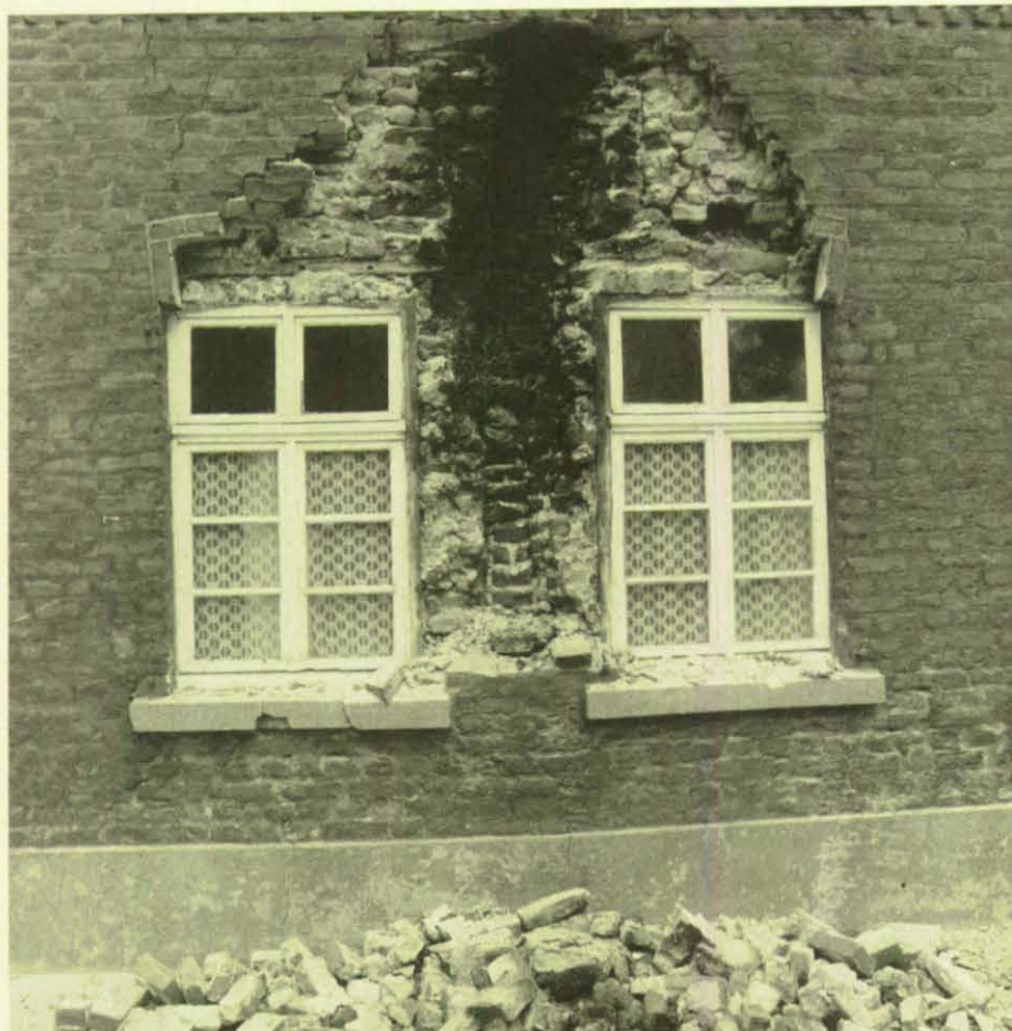
In Heinsberg kamen vor allem Backsteinbauten zu Schaden.
