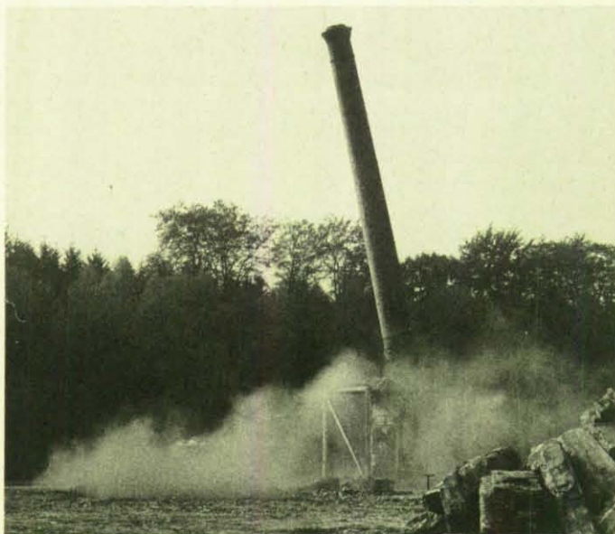
Die Sprengung ist gelungen: Der Schornstein fällt exakt in die vorausberechnete Richtung. (Foto: Löffel)
