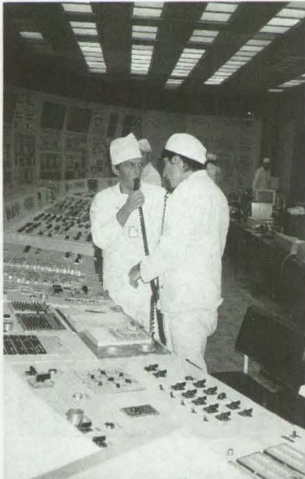
Blick in den Leitstand des Kernkraftwerks Leningrad in Sosnovy Bor.
