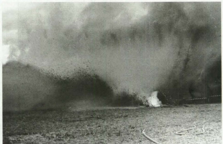
Der Moment der Sprengung: Schlagartig wird das Feuer „ausgeblasen“.
