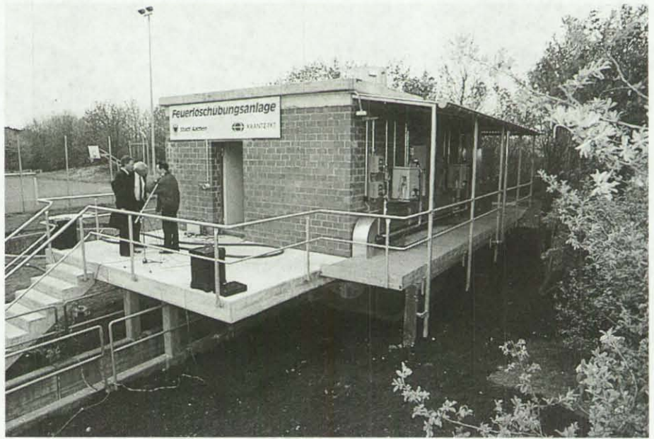
Das Brandhaus mit der neuen Technik. An der Außenwand des Gebäudes sind die notwendigen Geräte und Steuerungselemente montiert.
