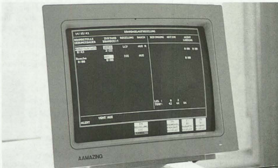
Auf dem Bildschirm wird der gesamte Zustand der Anlage ständig angezeigt.
