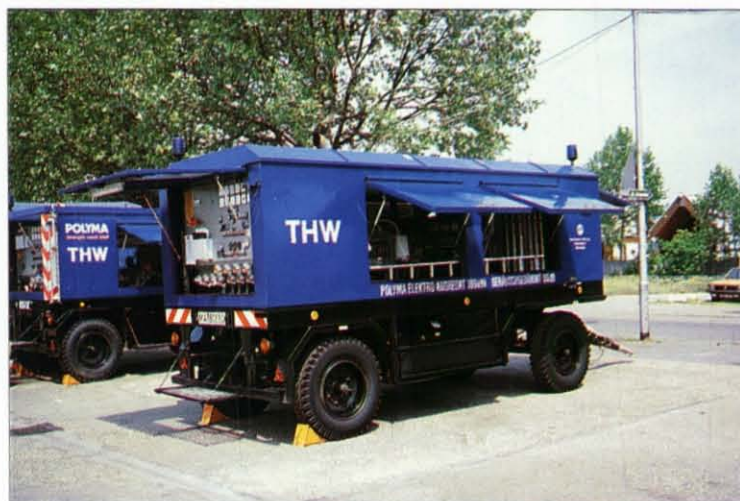
Das Notstromaggregat des THW-Ortsverbandes Mannheim. Hier sind alle Details für den Nachbau zu erkennen.
