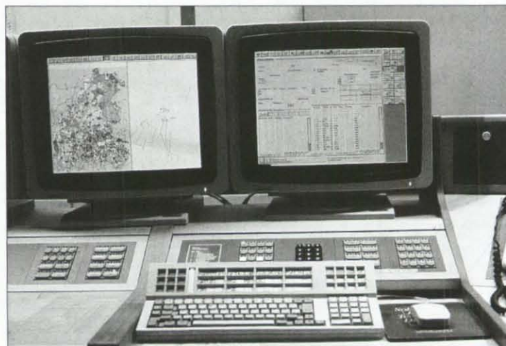
Blick auf einen der neuen Leitstellenplätze.
