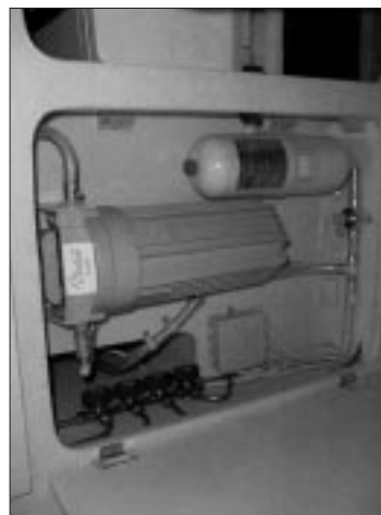
Aktivkohlefilter für die Wasserversorgung.
