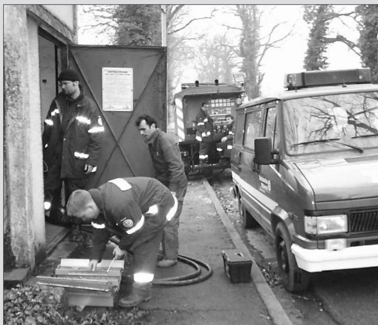
THW-Helfer versorgen ein Stromnetz per Notstromaggregat.
