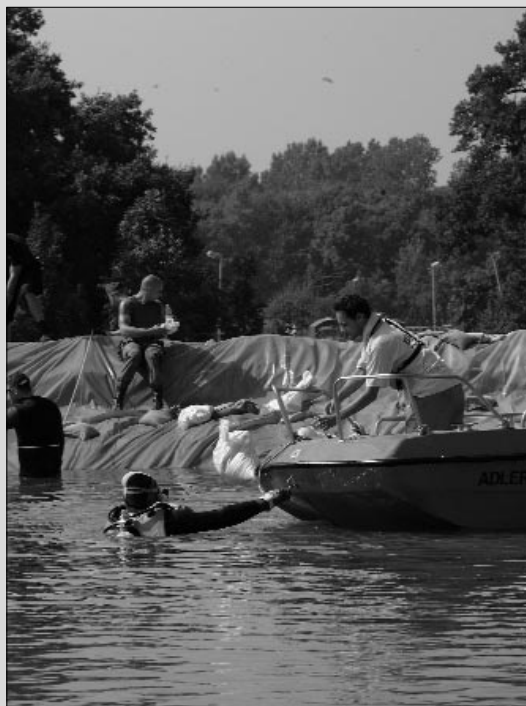
Die aufgeweichten Deiche mussten an der Wassenseite verstärkt werden.
