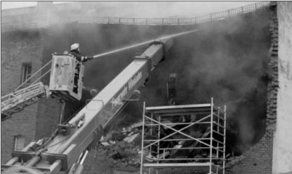
Wegen der herausgesprengten Hauswand musste das Dach mit Hilfe eines Kranwagens abgestützt werden, während von einer Drehleiter aus der Brand bekämpft wurde. (Fotos: Rüdiger Hentschel)
