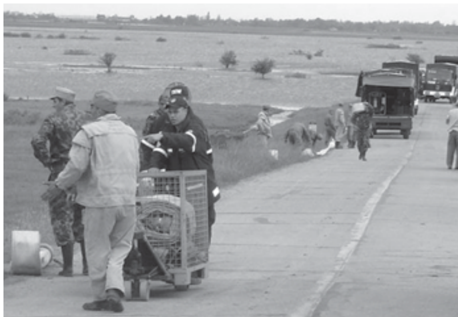
Dank tatkräftiger Unterstützung von Mitarbeitern der örtlichen Katastrophenschutzbehörde waren die Spezialpumpen des THW schnell aufgebaut. (Fotos: THW)
