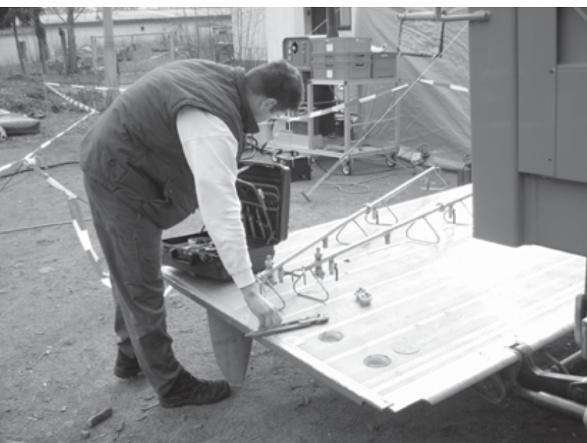
Für den Einsatz bei der Gerätedesinfektion mussten die Duschgestänge der Personendekontamination umgebaut werden. (Fotos: Steffler)
