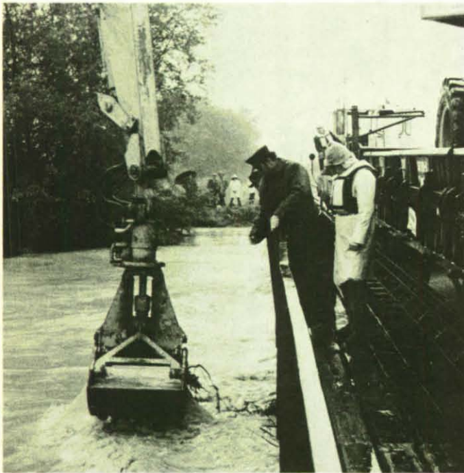
Angeschwemmtes Treibgut mußte an der Eisenbahnbrücke über die Ammer bei Weilheim beseitigt werden.
