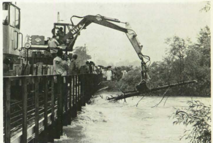
Mit einem Bagger mußten von dieser Eisenbahnbrücke aus an der Strecke Weilheim – Schongau querliegende Baumstämme, die das Hochwasser der Ammer angetrieben hatte, entfernt werden.
